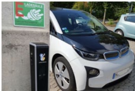
Ladesäule vor dem Landratsamt München am Marienhilfplatz Foto: Büchler
